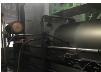
冷轧钢板清洗泵组
