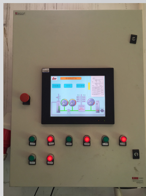
泵组测试平台
